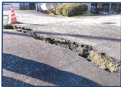
《上野地内の道路でひび割れ》
