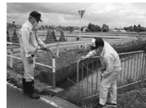
危険箇所一斉点検 (トラロープによる応急対策)
